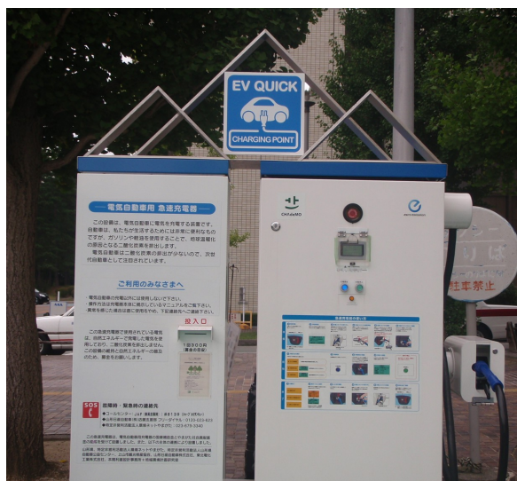
図2-2-3 県庁敷地内に設置された電気自動車急速充電器
