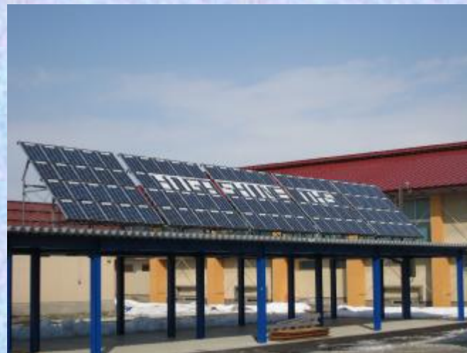
学校に設置した手作り 太陽光発電パネル
