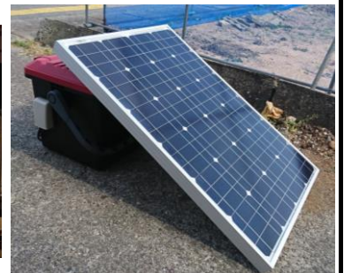
独立電源システム
