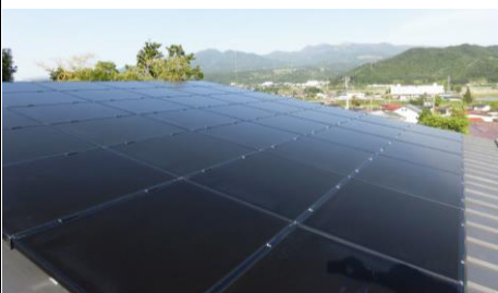
太陽光発電システム
