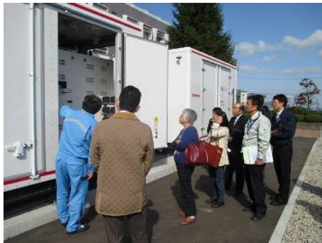
H29.10.24 宮城県:東北電力研究開発センター 水素製造システム施設視察
