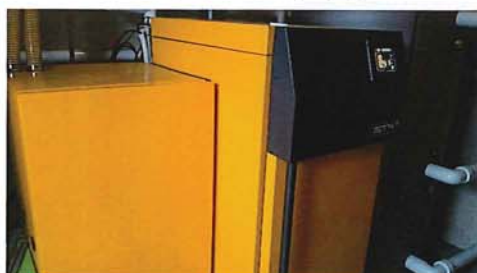
バイオマスボイラー
