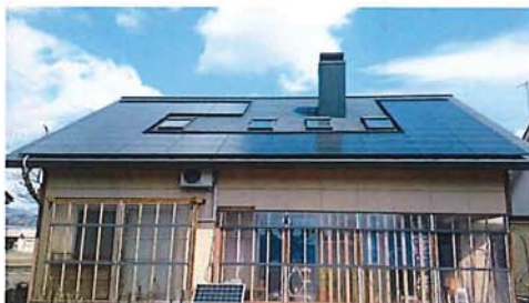
太陽光発電システム
